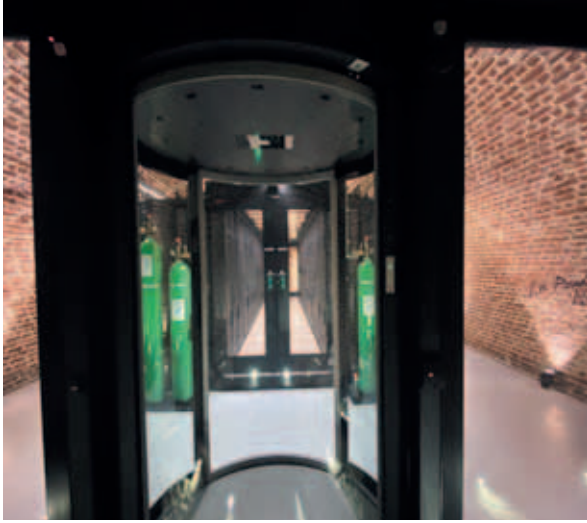
Le bâtiment de la Poudrière abrite le data center Décima © Paper Menthe
