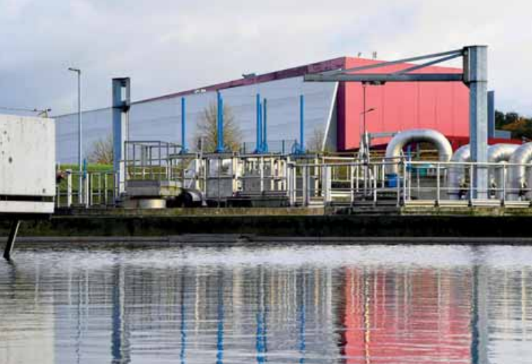
Station d'épuration © Veolia
